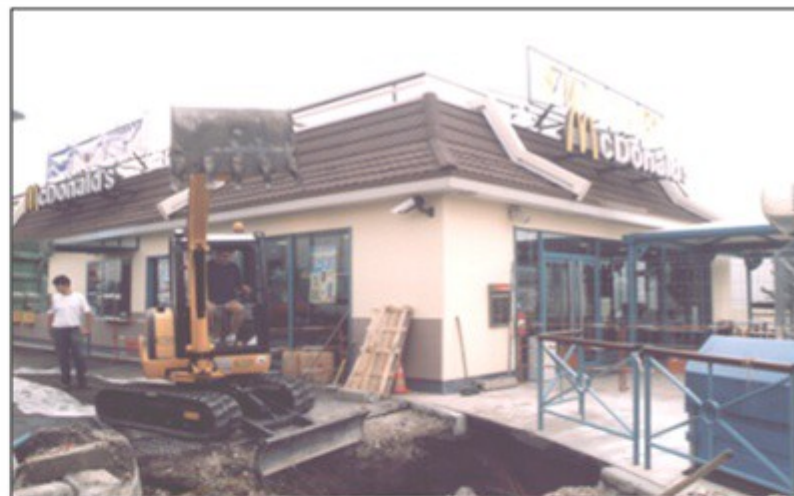
Juillet 2003 : effondrement localisé près d'un Mac Donald Concession du Cros)
