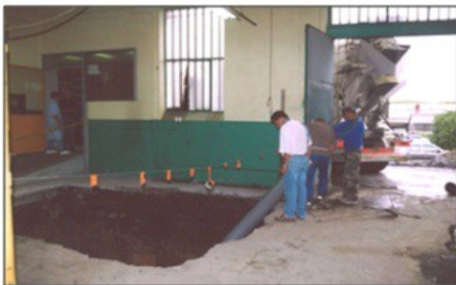
Juin 2003 : effondrement dans la concession du Treuil
