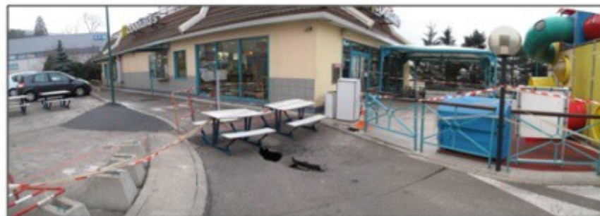
Mars 2009 : reprise d'effondrement du Mac Donald
