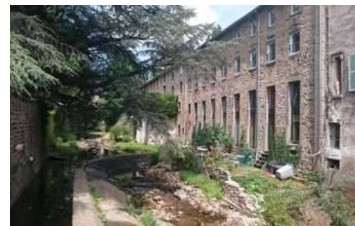
Bâtiment industriel réhabilité en ateliers d'artistes et logements, centre-bourg de Saint-Julien-Molin-Molette (42) Source : CEREMA
