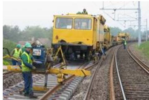
Longs Rails soudés sur traverses béton
